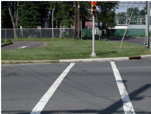
Missing ADA curb cuts
